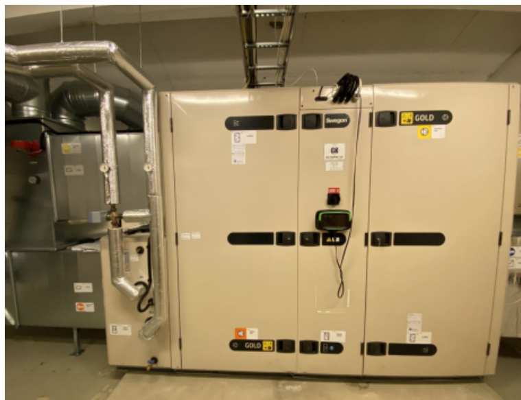
Figur 20 Ventilasjonsanlegg i Etg 2, fra 2014.
